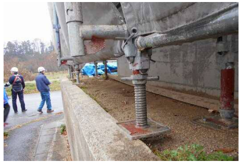
不安定な足場立て地の脚部
